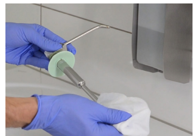
7b. Desinfektion der Dosierpumpe.
